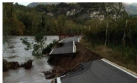
La grossa frana che ha subito la Cicladige sulle rive del fiume in piena
