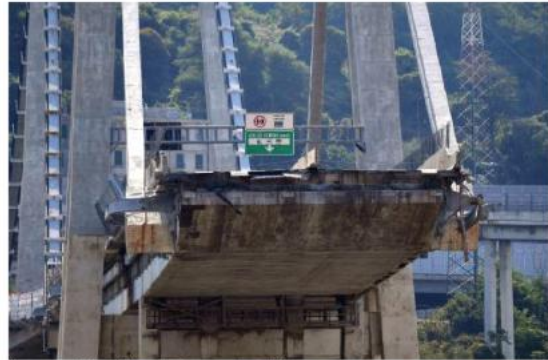
Il lato ovest del ponte Morandi a Genova, crollato il 14 agosto
