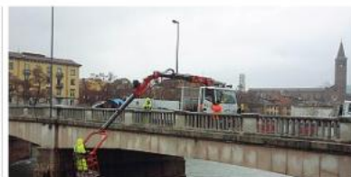
Verifiche Un sopralluogo sulle condizioni di ponte Nuovo negli anni scorsi. Il monitoraggio è costante
