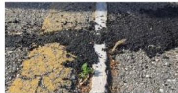
Il bitume versato poche ore dopo l'infortunio in via Urbano III
