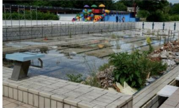
Le vasche del Lido di via Galliano sono in degrado, difficile riaprirle in tempi brevi
