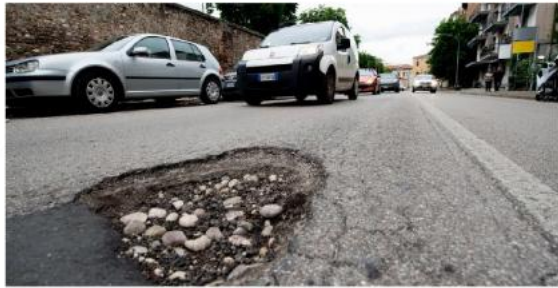
Via del Minatore, sezione nell'asfalto proprio accanto ad una precedente «toppa» (Foto: M. Basso)
